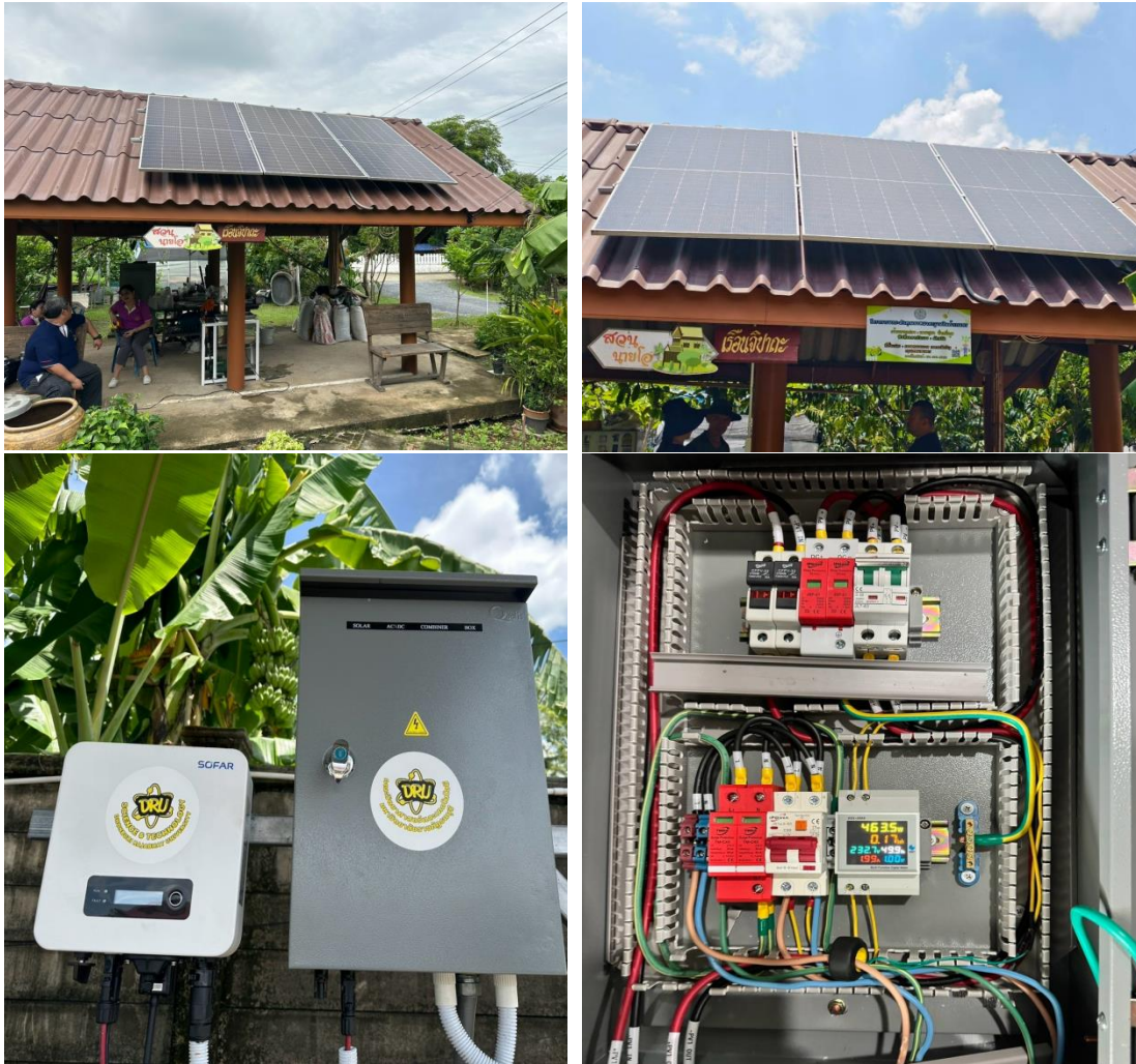
รูปที่ 4 การติดตั้งระบบควบคุมพลังงานแสงอาทิตย์ร่วมกับระบบไฟฟ้าบ้าน
