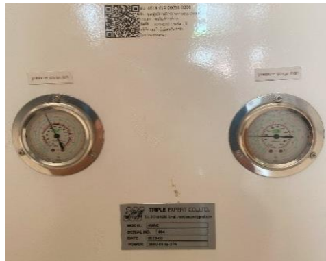
รูปที่ 2 เกจวัดความดันสารทำความเย็นด้านแรงดันต่ำและแรงดันสูง
